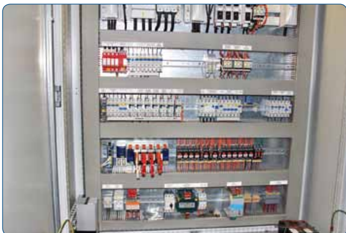
4. ábra A beépített PCD3 vezérlőegység
