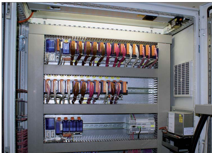
2. ábra A tűzvédelmi vezérlő készülékegyüttes
