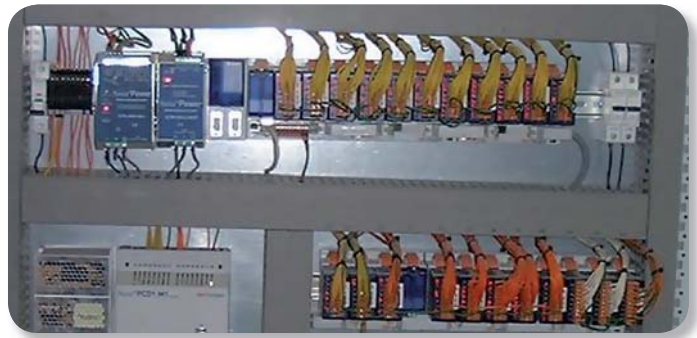
6. ábra: Az élményelemekért felelős PLC
