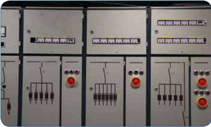
3. ábra Beépített fogyasztásmérők
