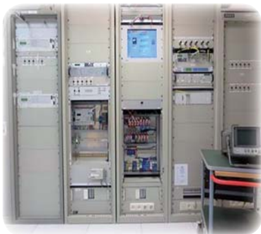
A felújított vezérlés
