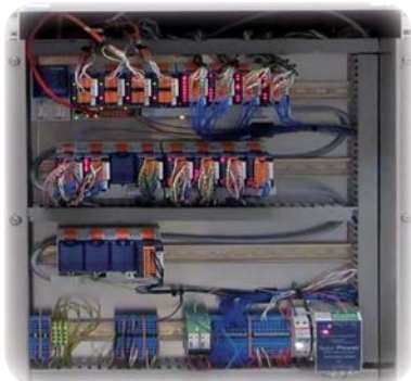
A kapcsolótábla belső elrendezése
