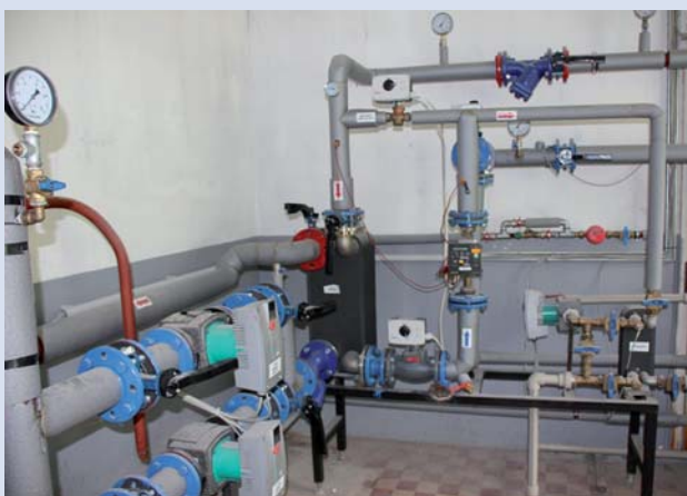
3. ábra A hőközpont a felújítás után
