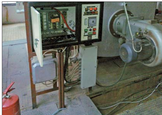
2. ábra A „megörökölt” vezérlés a felújítás előtt
