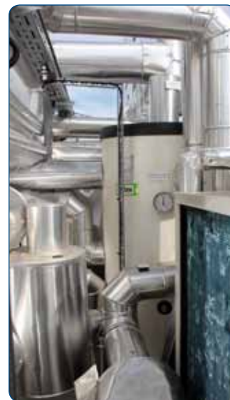
5. ábra A tetőtéri nyitott kazánház
